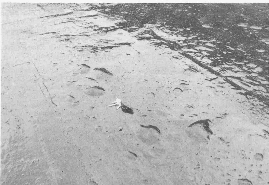
Bild 3. Blasen unter einer kunststoffmodifizierten Bitumenfolie
