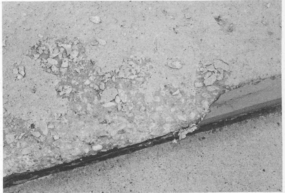
Bild 4. Durch Tausalz-Temperaturschock zerstörter Beton. Beachtenswert ist die unterschiedliche Betonart der Oberfläche und des Kernbetons. Die Beschichtung konnte die Zerstörung nicht verhindern
