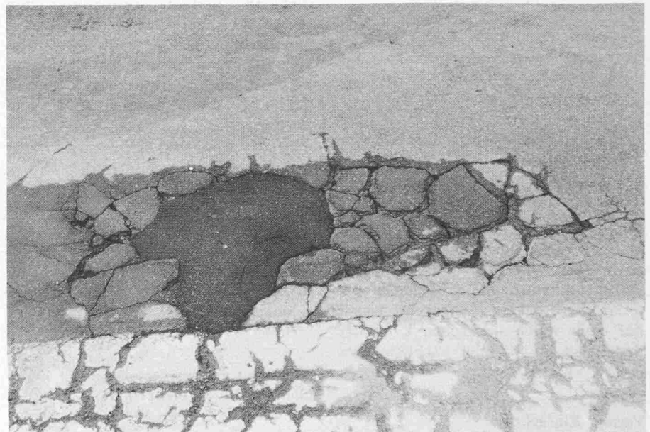
Bild 5. Durch nachgiebige (weiche) Unterlagen wurde dieser Walzasphalt nach wenigen Wintern zerstört
