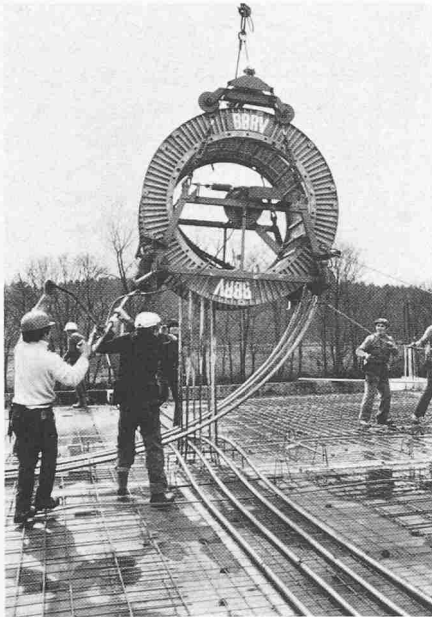
Bild 8. Verlegen der Kabel mit Kran und Abrollgerät von der Bobine direkt auf die Kabelhalter
