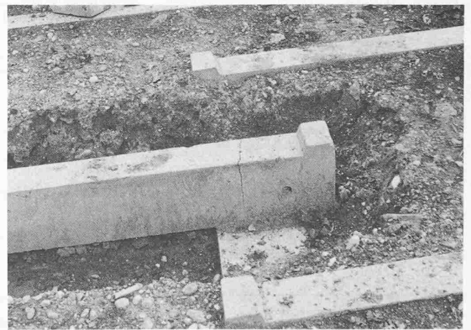
Bild 5. Typischer Biegeriss im Auflagebereich des Rucksackbinders als Folge der stark ungleichmässigen Lagerungsbedingungen dieser Binder
