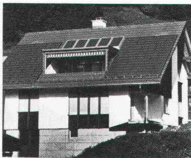
Energiedach in Ebnat-Kappel SG
