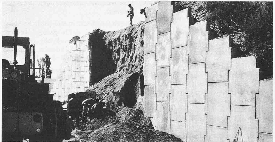
Bild 20. Versuchsbauwerk aus bewehrter Erde. Die speziell dünne Bewehrung wurde für eine Lebensdauer von 8 Monaten ausgelegt. Nach 9 Monaten ist das Bauwerk zusammengebrochen
