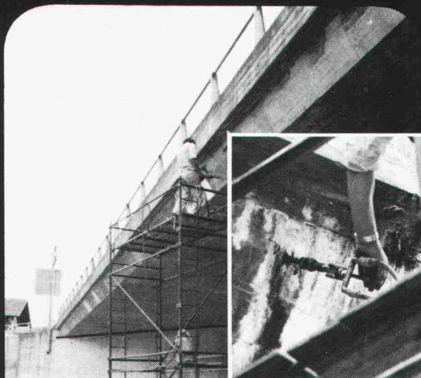
Risse in Betonbauwerken Abdichtung mit Renesco- Flexin-Injektionen
