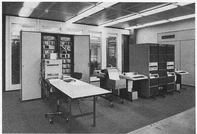
Bild 11. Rechnerraum, Schränke mit Mikroprozessoren für die Zugnummernmeldung und Zuglenkung ZN 80 während der Testphase (links), Rechner PDP11 mit Service-Terminal für die codierte Stellwerkbedienung (rechts)
