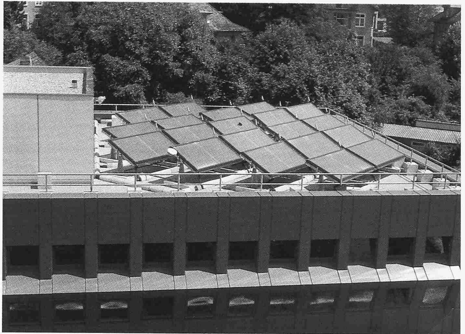
Bild 9. Sonnenkollektoranlage. 20 Elemente mit insgesamt 55 m 2 Absorberfläche. Ausrichtung nach Süden, Neigung verstellbar 30–60°.
