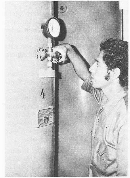
Bild 31. Gefährlich angeordneter Prüfmanometeranschluss
