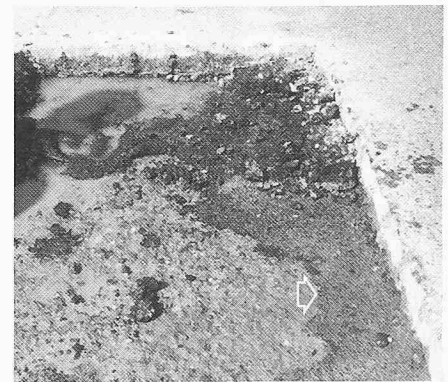
Bild B4. Probe 1: Der Belag ist entfernt. Die Abdichtung ist mit einer anhaftenden Betonschicht von bis zu 8 mm herauslösbar. Der linke und der rechte Rand der Abdichtung haften wieder fest an und mit dem Beton (Pfeil). Am tiefsten Punkt stehendes Wasser
