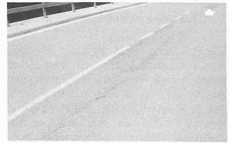
Bild A2. Belagsschäden mit Schieberissen im WA. Die beschädigte Seite hatte folgende Hohlraumwerte: Ausgleichsschicht 5,1-7,5 Vol.-%. Verschleisschicht 4,0-7,4 Vol.-%. (Pfeil: Probeentnahme, vgl. Bild A3)
