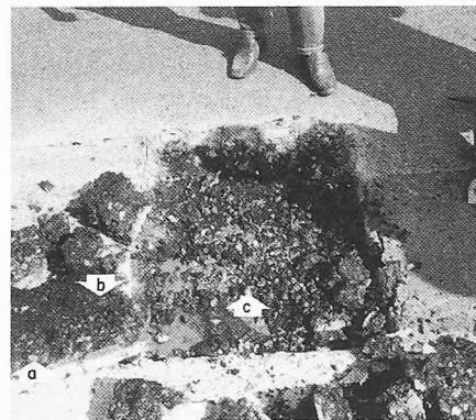
Bild B3. Probe 1: Der WA-Belag (Belagsstärke 11 cm) ist an der Unterseite ausgewaschen (a). In Bruchflächen löst sich die Bitumenhaut vom Splittkorn (b). Auf der Abdichtung liegt ausgewaschener Splitt und stehendes Wasser aus dem Belag (c)
