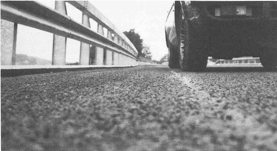
Bild 6. Griffiger GA-Belag auf Brücke, nach 5 Jahren Beanspruchung
