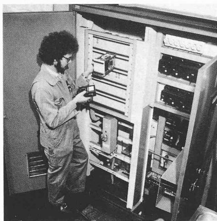
Bild 13. Elektroniker prüft Einschubeinheit
