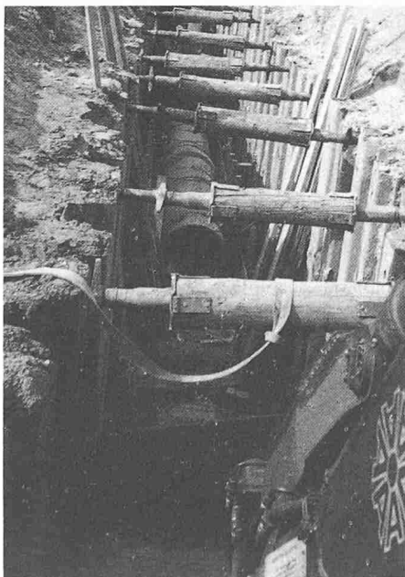
Rohrverlegung auf vorbereiteter Betonsohle im gespundeten Graben auf der Höhe des Grundwasserspiegels
