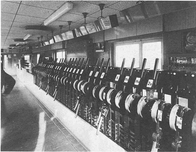
Bild 2. Blick ins bestehende Stellwerk aus dem Jahre 1898
