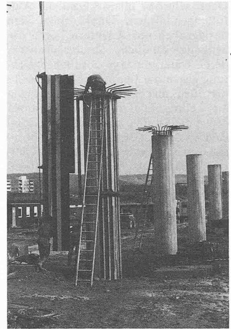
Bild 6. Stützen vorne: mit dem Überbau monolithisch verbunden hinten: zur Aufnahme der Punktkipplager
