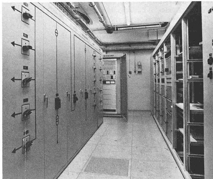
Bild 3. Niederspannungsverteilung mit Grobnetzverteiler, E-Technik-Schränken und Messtechnikschrank
