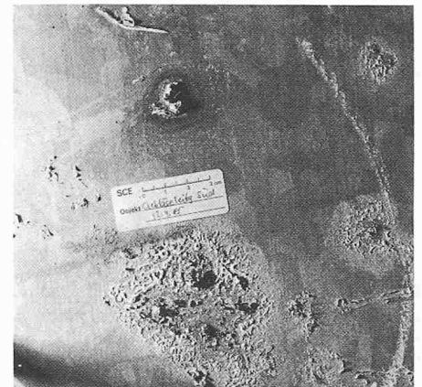
Bild 1. Verzinkungsfehler, die in der Verzinkerei nicht gesehen, von der Korrosionsschutzüberwachung auf der Baustelle jedoch entdeckt wurden
