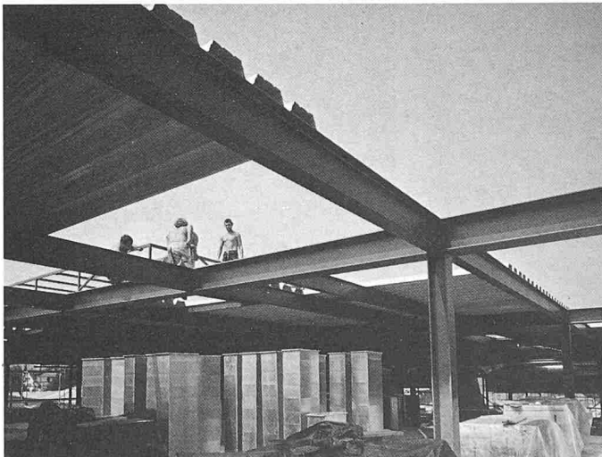
Bild 8. Im Baukastensystem verschraubte Dachträger eines Einkaufszentrums. Montage und Ausbau verlaufen fast parallel
