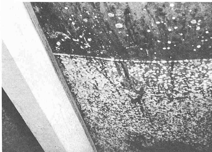
Bild 2. Pilzbildung am Unterdach
