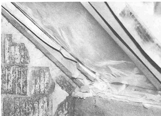
Bild 3. Nicht luftdichte Anschlüsse bei Sparren und Schwelle
