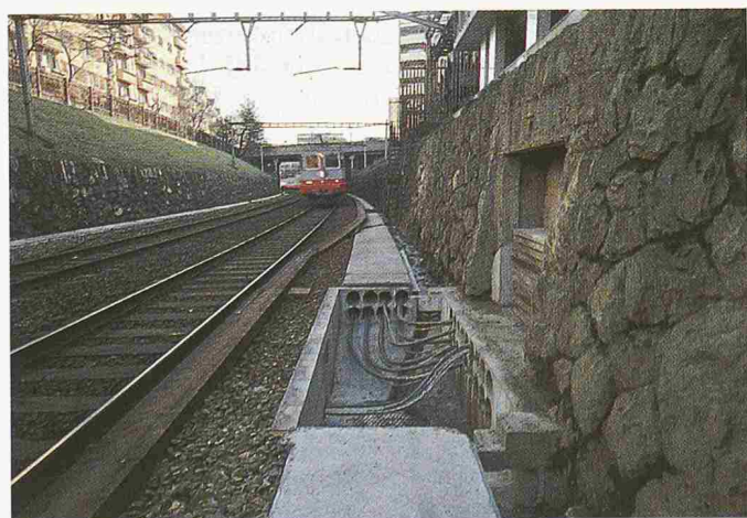
Bild 2. Rohrblock unterhalb der Hauptschaltanlage des Bahnhofs Luzern
