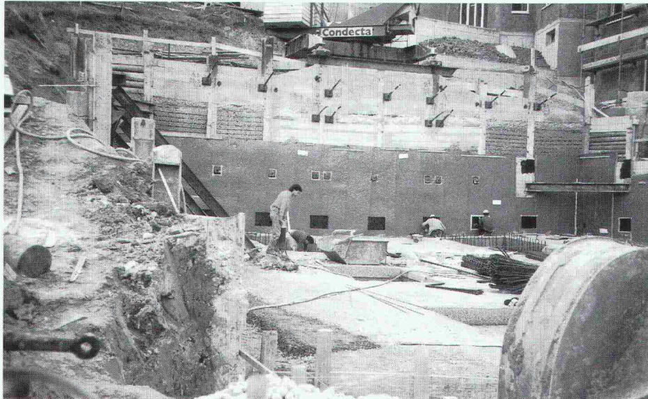
Raumgewinn dank Enkadrain CK bei der Überbauung Haltenreben in Winterthur-Wülflingen (Zani Generalunternehmung AG, Winterthur)
