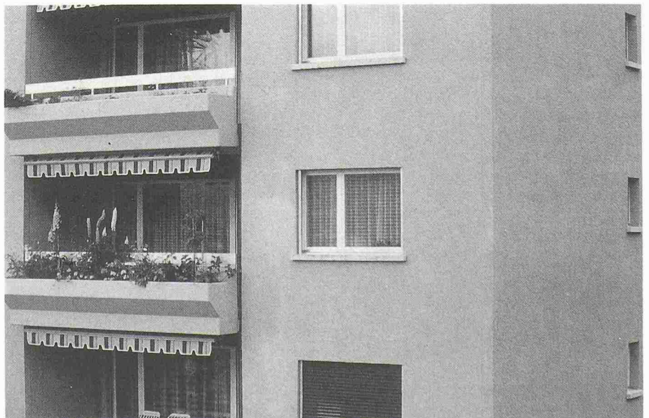
Bild 6. Kalkausblühungen (weisse Flecken) an der Deckputzoberfläche eines mineralischen Putzes mit einem Mineralanstrich. Die Ausblühungen sind eine Folge der zu hohen Mauerwerksfeuchtigkeit vor den Verputzarbeiten
