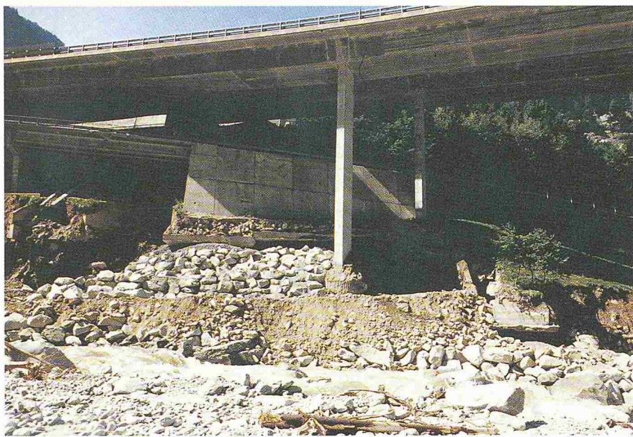
Bild 12. 15000 m 3 Stein- und Steinbruchmaterial; gelungene Unterstellung von Widerlager und Stützmauer am 29.8.1989, Mitternacht Bildautor: T.R. Schneider, 1879/8
