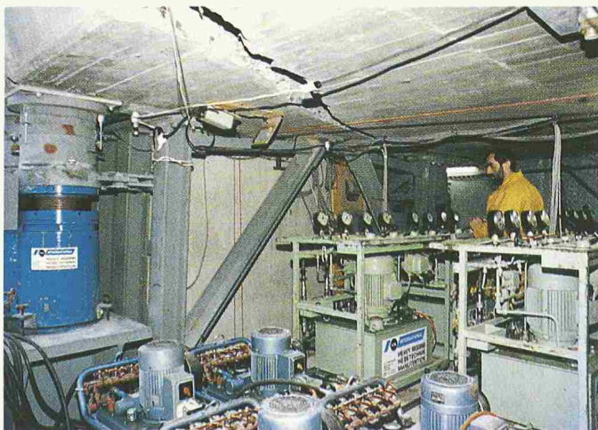
Bild 9. Hydraulikaggregate und horizontale Pressenfixierung (L. Buscarlet)
