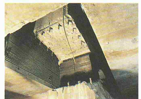
Bild 18. Notstapel zwischen Pfeiler und Pfeilerstummel (L. Buscarlet)
