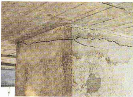
Bild 11. Rissbild am Pfeilerkopf (A. von Glutz)
