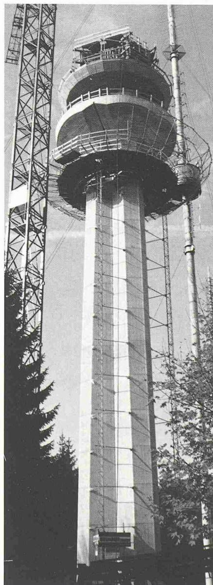
Der 55 m hohe Betonunterteil des zukünftigen, insgesamt 185 hohen Antennenturms auf dem Üetliberg ist fertiggestellt (Bild: Brunners Erben)
