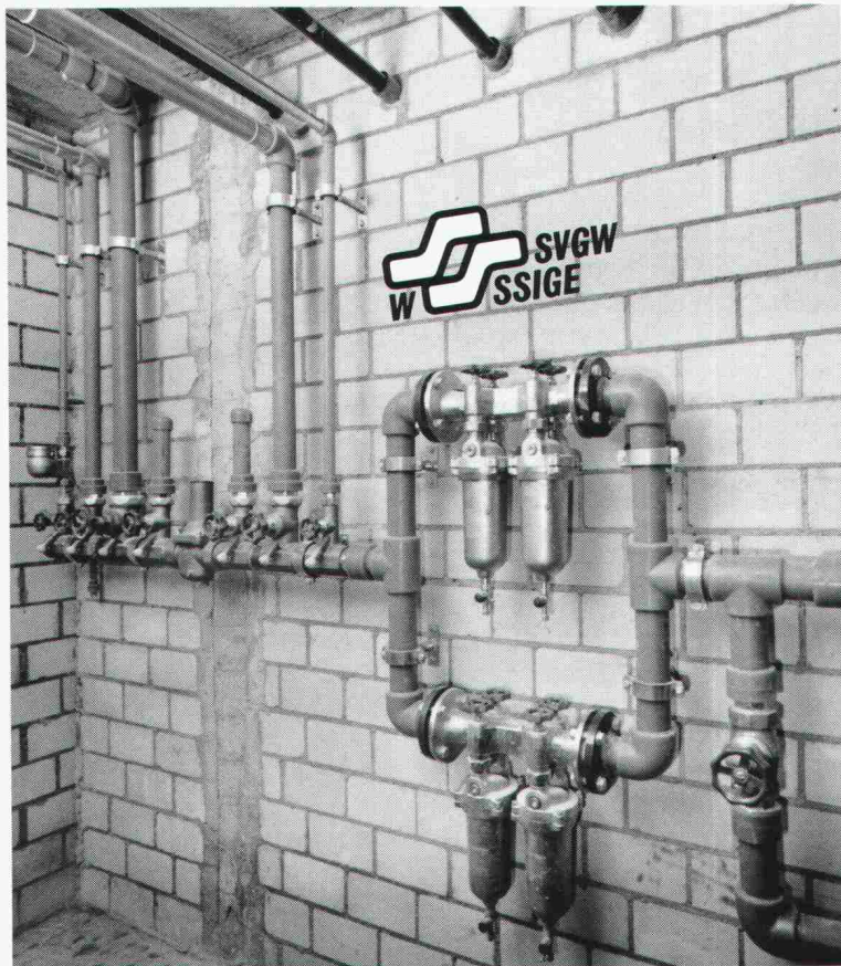
Verteilerbatterie in der Mövenpick-Raststätte «Heidiland» bei Sargans
