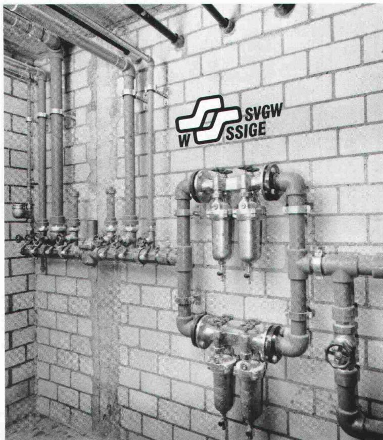
Verteilerbatterie in der Mövenpick-Raststätte «Heidiland» bei Sargans
