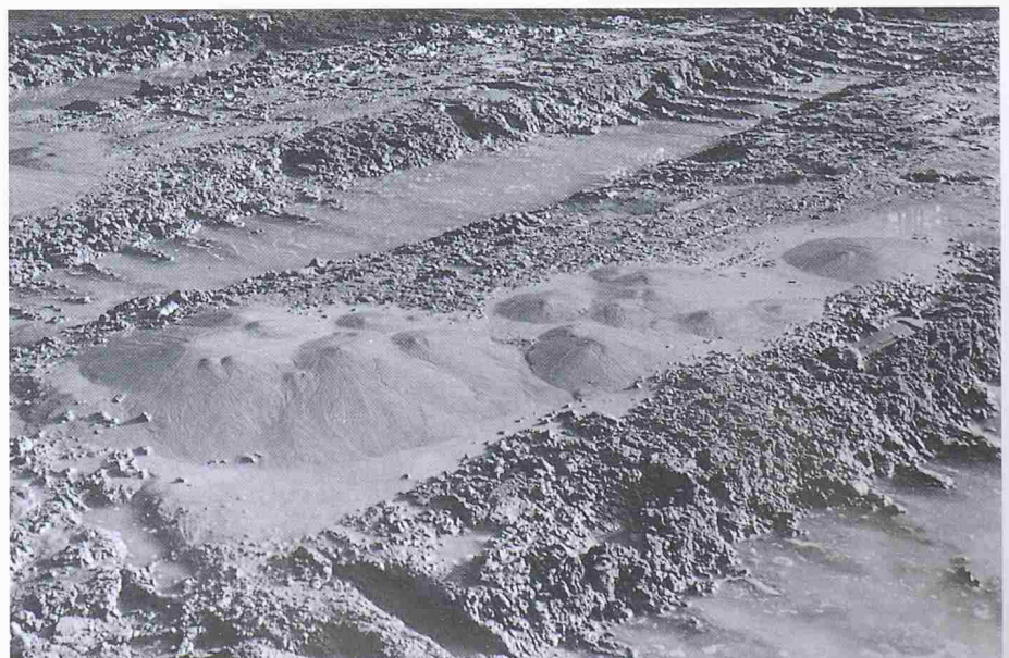
Foto: Vulkanartige Materialausschwemmungen unter Verlust der Tragfähigkeit einer Baugrubensohle infolge hydraulischem Grundbruch
