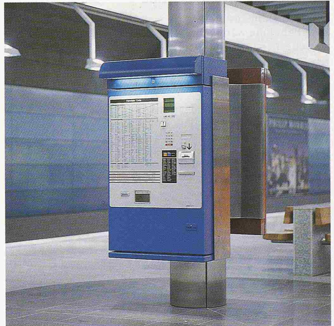
Bild 6. Säulenmontierte Apparate: Billettautomat und Fahrplaninformation
