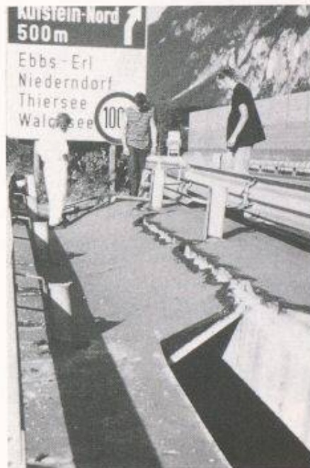
Bild 1. Inntalbrücke bei Kufstein nach dem Schadensfall
