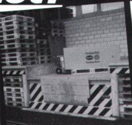
z. B. Scherenhebebühne in der Rampe eingebaut, mit eingehängtem Überfahrblech und Spezial-Sicherheitsblechschürze.
