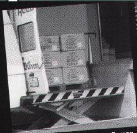
z. B. Scherenhebebühne vor der Rampe, abgesenkt mit Lastwagen überfahrbar.
