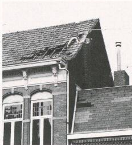
Bild 4. Beispiel für Kamin- und Dachschäden im Stadtkern von Roermond
