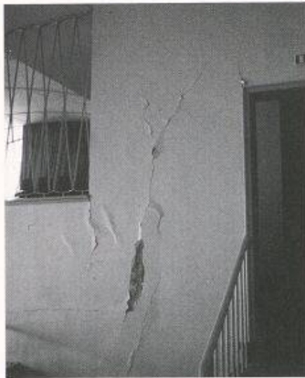
Bild 7. Schäden an Innenwand der Festhalle in Oberbruch/Heinsberg als Folge von Zwängungsbeanspruchungen
