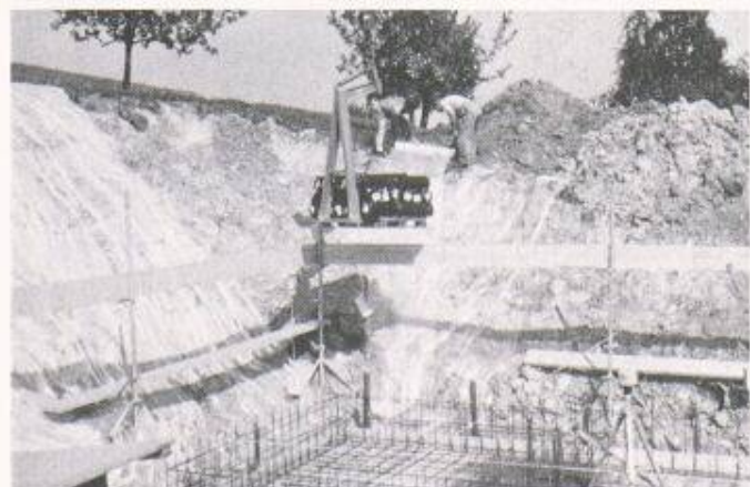
Eine der typischen PE-Anwendungen im Baubereich: Polyethylenfolien schützen Baugruben vor witterungsbedingten Erdrutschen
