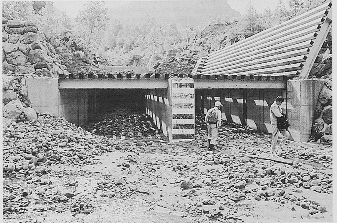
Bild 12. Murgangsbremse beim Kamikamihorizawa am Mount Yakedake
