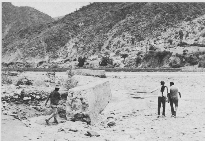
Bild 1. Uferschutzmauer. Das raschere Wegfliessen in der Nähe der Mauer führt zu einem seitwärts gerichteten Zufluss aus der Mitte des Flussbettes (Bild: E. Decormis, Sucre)
