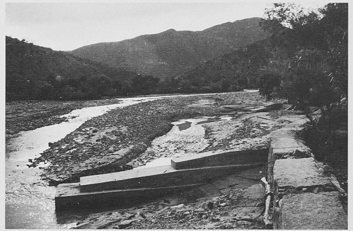
Bild 7. Auskolkung an einer Buhne (Bild: E. Decormis, Sucre)
