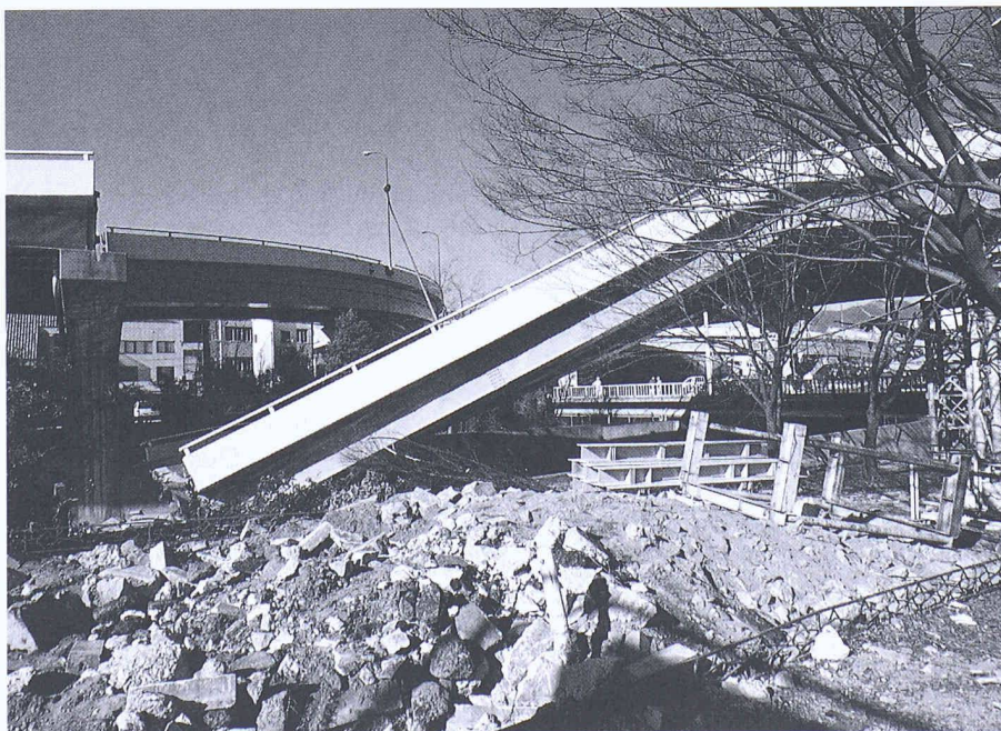
Bild 11. Absturz des Trägers einer Verbundbrücke
