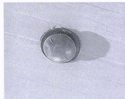
Bild 7. Kugelförmiger Luftauslass in der Küche (Beispiel Riehen)
