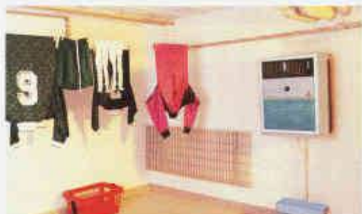
Auf Wunsch liefert und montiert Roth-Kippe AG die komplette Waschkabineinrichtung: Wäschetrockner, Wäschehänge-Einrichtungen, Waschmittelbehälter und Akkumulatorstele.
