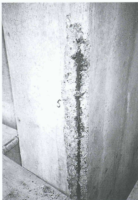
Betonabplatzung und rostige Bewehrung (Längsseisen und Bügel: Querschnittsverminderung rund 10% infolge chloridinduzierter Korrosion)
