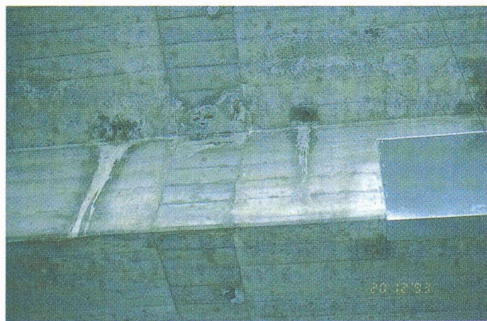
Korrodierte Spannkabel oberhalb der Hohlstrasse
