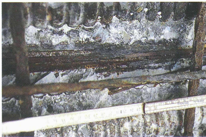
Belagsentlüftungsröhrchen (teilweise wasserführend)
