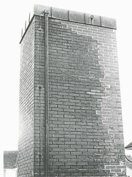
Schäden am Kamin
