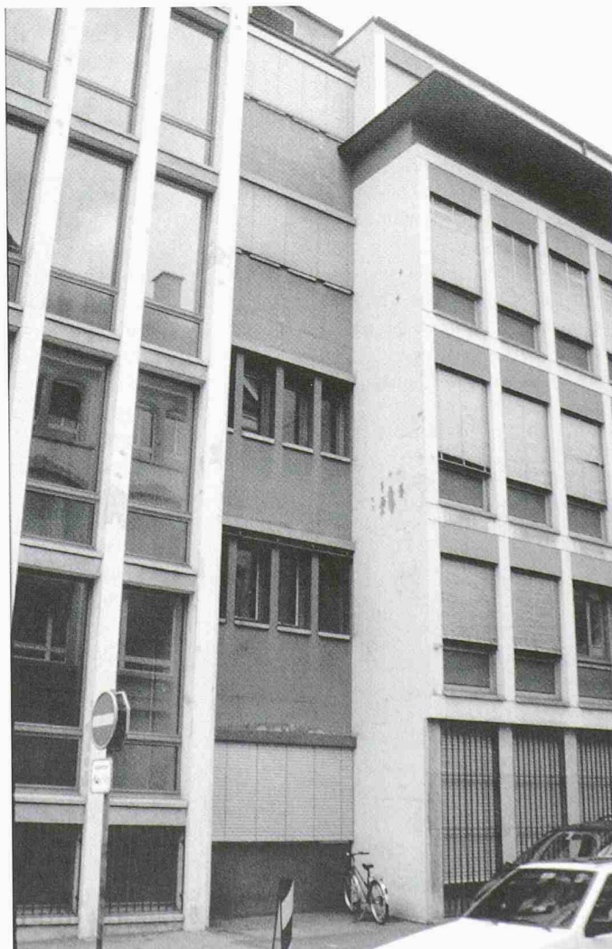
1 Feingliedrige Bauteile mit Altanstrichen sowie sichtbare Betonabplatzungen und Bewehrungskorrosion
