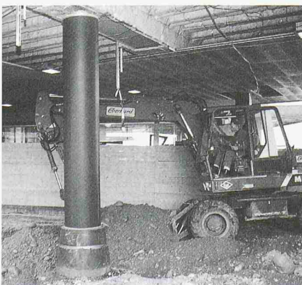
Zu entfernende Stütze unter der Fingerwurzel A während des Aushubs der Baugrube
