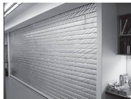
Brandschutz-Rolltore im Untergeschoss
