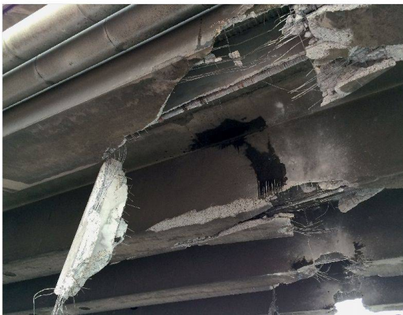
Der Ausleger zerschneidet die Hohlkastenträger. Die Hüllrohre mit den Vorspannkabeln wurden freigelegt, aber nicht verletzt.
