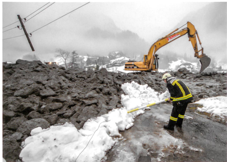
Eine Schlammlawine verschüttete im Januar 2016 die Bezirksstrasse bei Stalden im Muotatal und unterbrach dabei die Stromversorgung.
