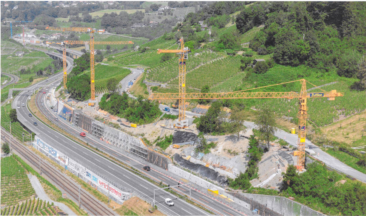
Das Pilotprojekt für die Verstärkung der Stützmauer an der A5 und A9 umfasste 38 Stützbauwerke und kostete 150 Millionen Franken.
