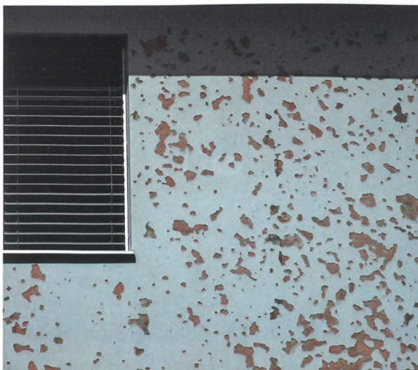
Hagelschäden am Verputz einer Fassade.
