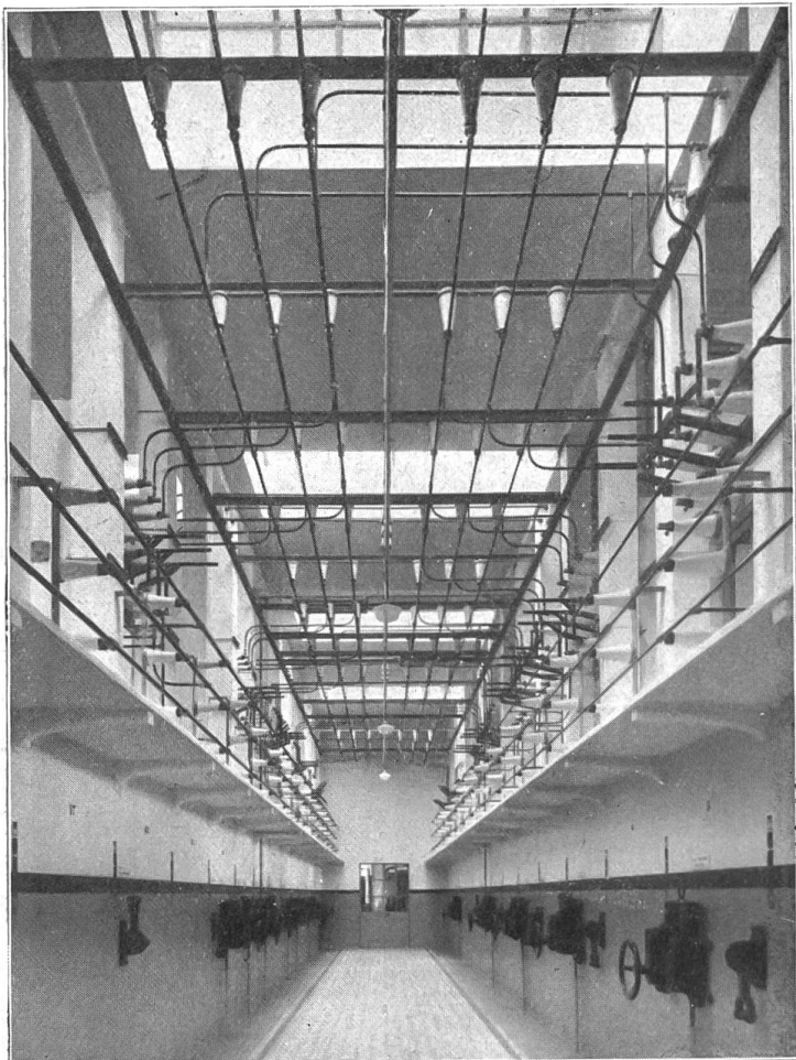
Fig. 11. Poste de Montcherand. Vue du couloir central.
