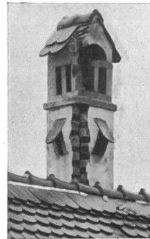
Fig. 23. Fall 127—32, in Schwarzenburg. Der zerstörte Kamin.
