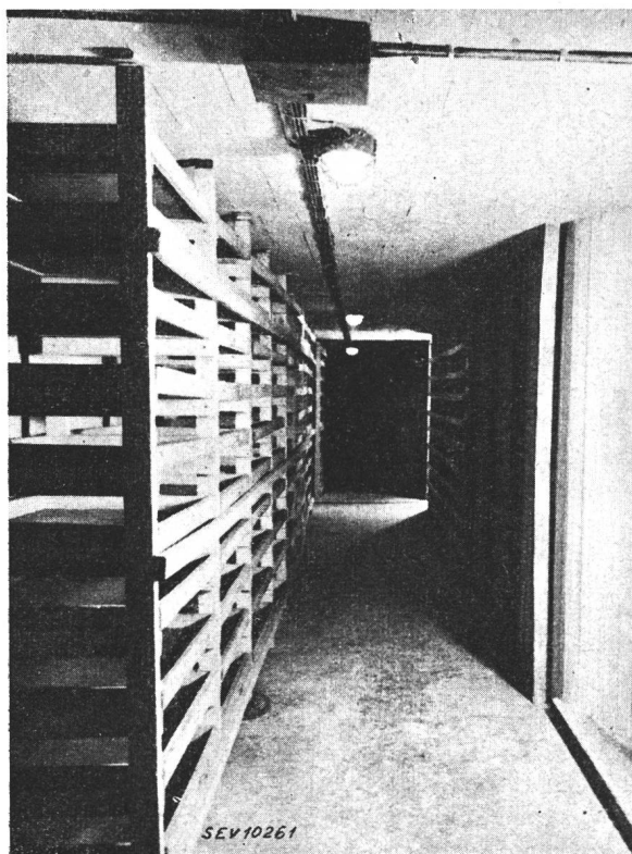
Fig. 1. Dörrhurden im Generatorabluftkanal.
